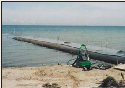
Contenedores Geotube® siendo colocados para crear espigones en la obra de toma de una granja camaronera.
