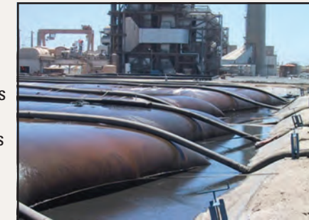
Contenedores Geotube® en la planta de energía de combustible fósil usados para filtrar ceniza.
