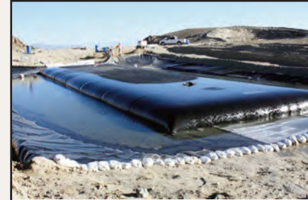
Residuos provenientes de una mina de oro, de lagunas de sedimentación, deshidratándose en unidades Geotube®.
