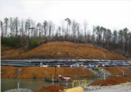
Deshidratado de lodos y celda de confinamiento
