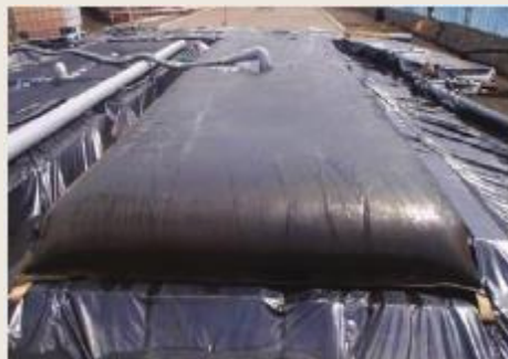
Deshidratación de lodos de hidrocarburos
